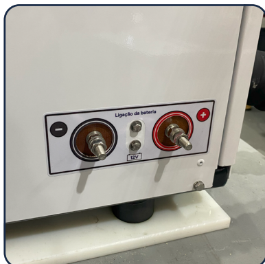
Ligação dos cabos da bateria
