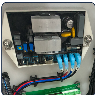
AVR (regulador de voltagem)
