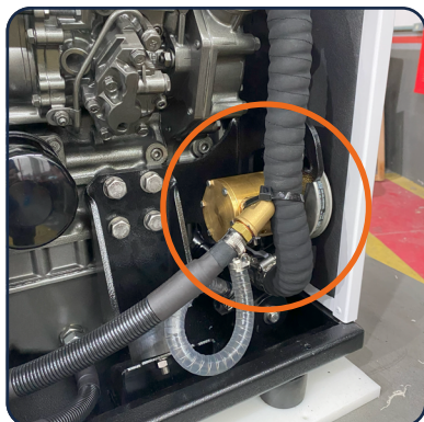
Bomba de refrigeração e correia
