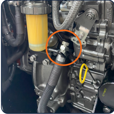
Dreno para remoção do óleo lubrificante
