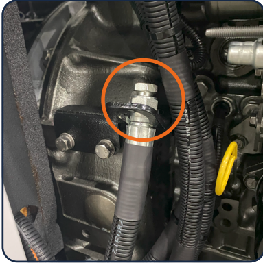
Dreno para remoção do óleo lubrificante
