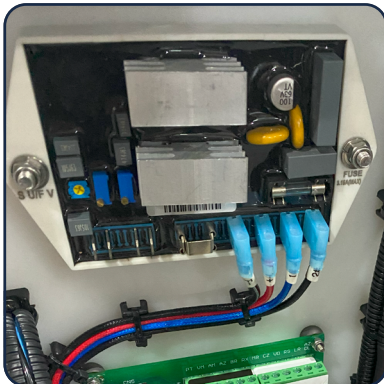
AVR (regulador de voltagem)
