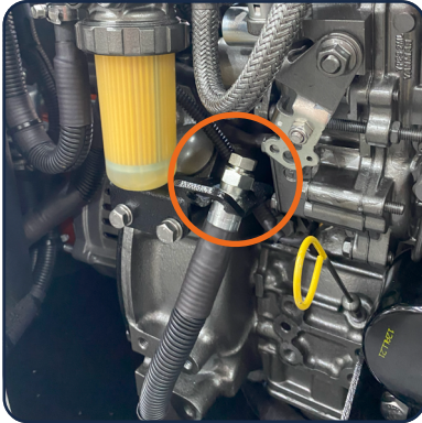
Dreno para remoção do óleo lubrificante
