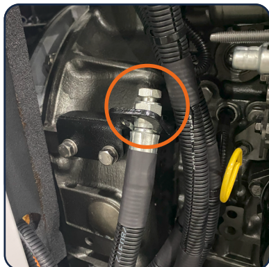
Dreno para remoção do óleo lubrificante
