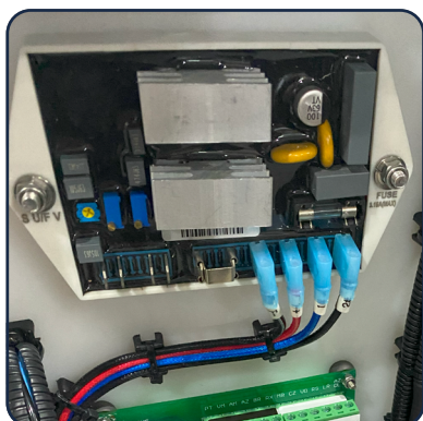
AVR (regulador de voltagem)
