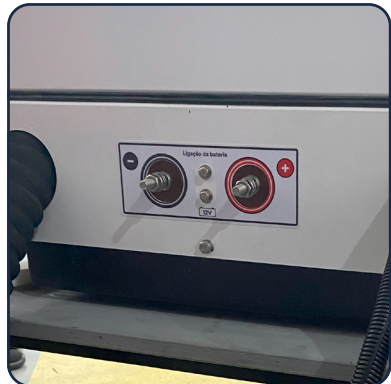
Ligação dos cabos da bateria
